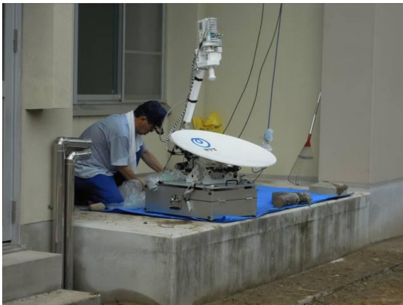
昨日(7/29)小川小学校に設置した特設公衆電話(ポータブル衛星システム)
