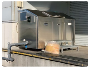
丸亀市給食センターに設置した食品残渣発酵分解装置
