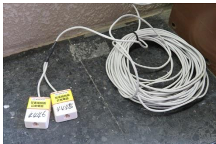
〔1〕 平常時はモジュラージャックまで設置されています。
