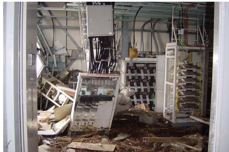
②伝送設備 (岩手県 野田村設置)
