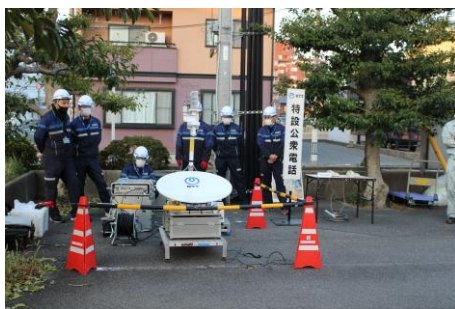
特設公衆電話設備 設置完了
