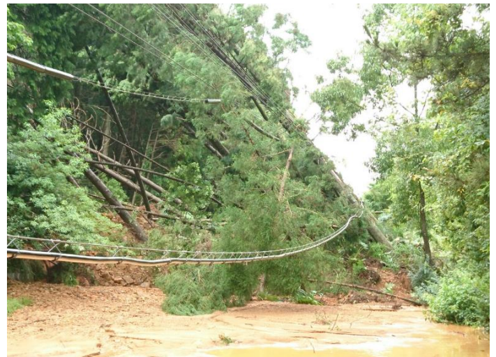
土砂崩れによる電柱倒壊・通信ケーブル切断(熊本県芦北町)
