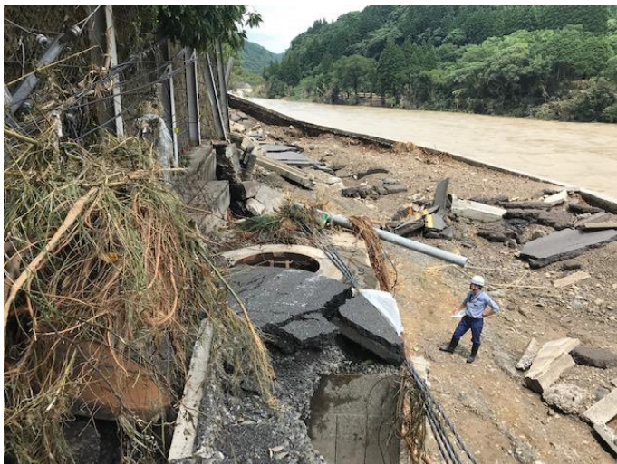
道路崩落によるケーブル切断(熊本県球磨村)
