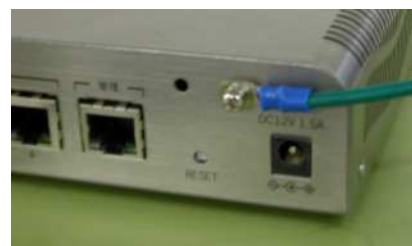
FG ケーブル取り付け状態
