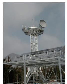
三重支店水ヶ平無線中継所
