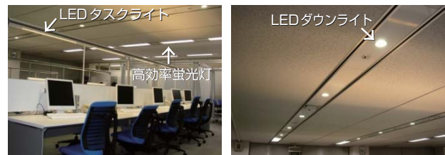
図2 新たに設置した照明の外観
