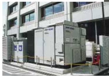
燃料電池コジェネレーションシステム(広島支店)
