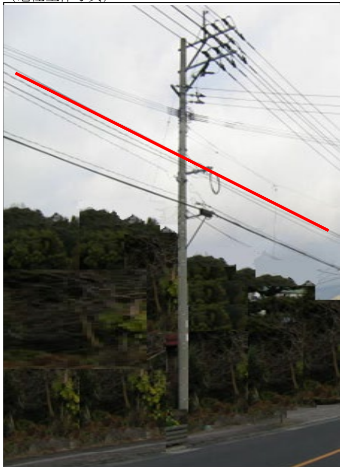
(電柱全体写真)
