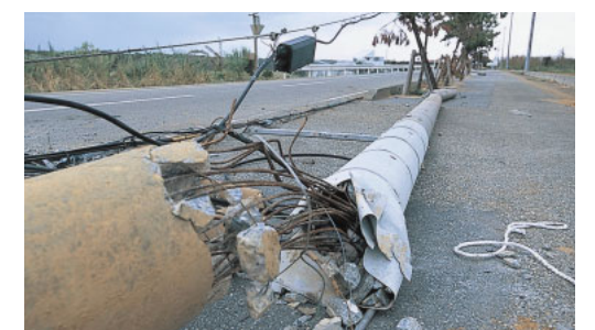
台風により倒壊した電柱
