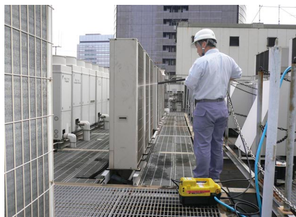
空調設備のフィルターを洗浄
