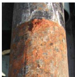
土中で腐食した鋼管柱
